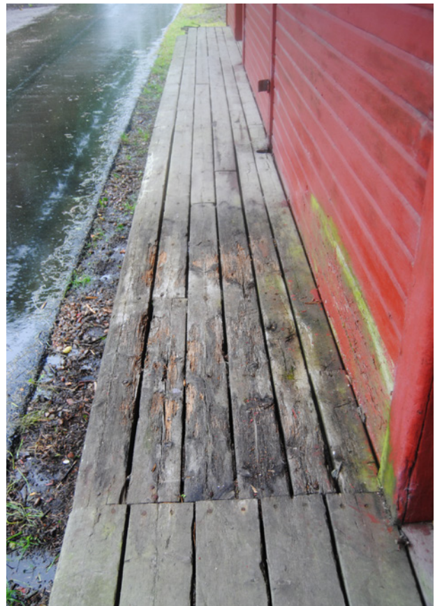
Lastbryggan mot norr har rötskador på grund av läckaget i taket.
