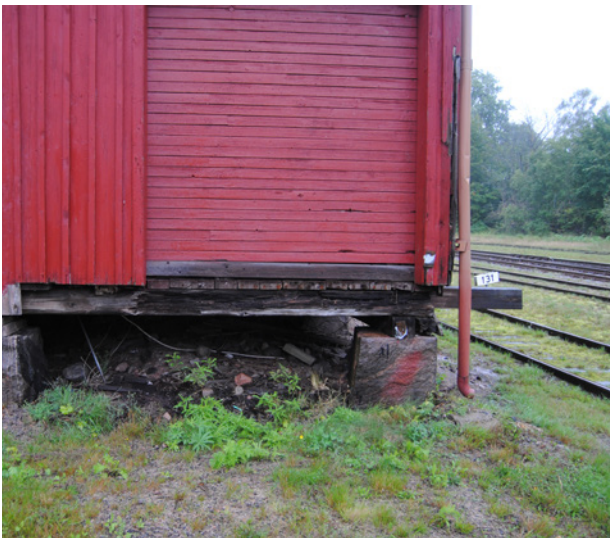
Exponerad syll på östra gaveln som fått rötskador.
