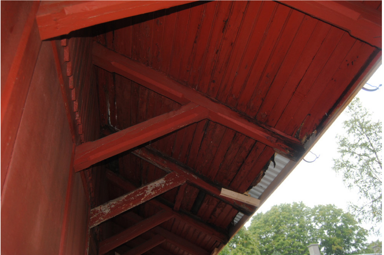
Takfoten mot norr har rötskador.
